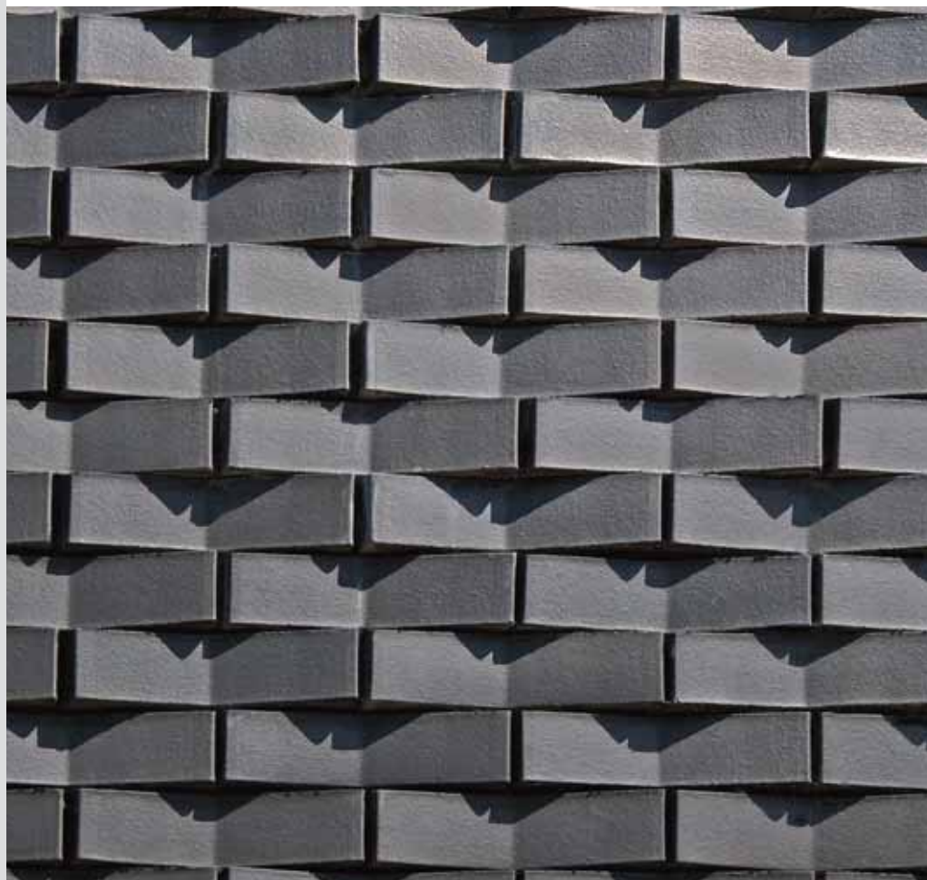
Ansicht von vorne: Schattenklinker ohne Mörtelfuge geklebt
